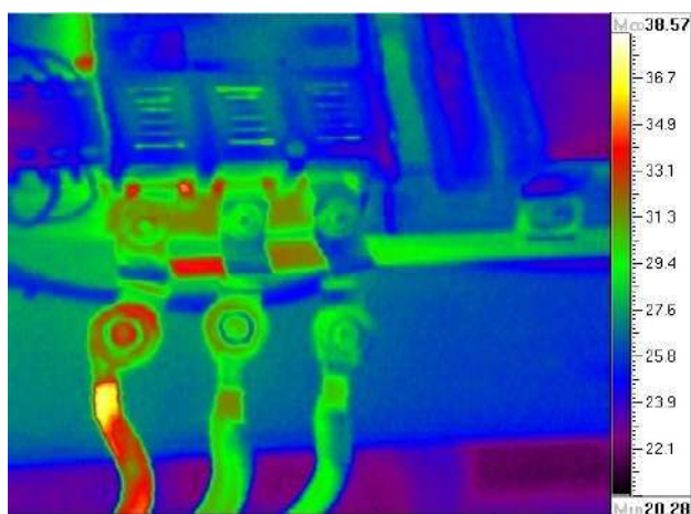
Рисунок 21. Пример термограммы контактных соединений с температурной шкалой
