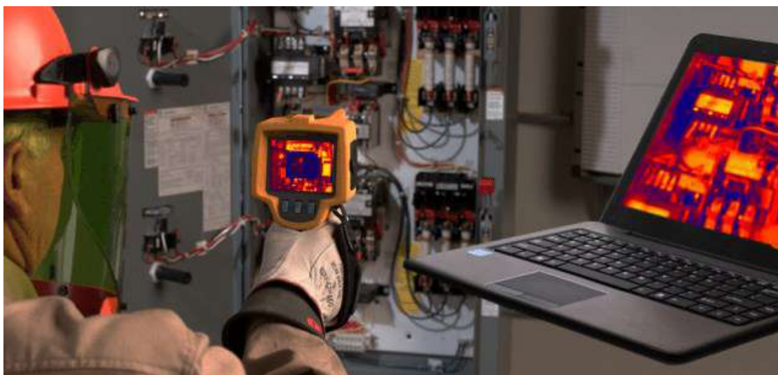
Рисунок 20. Пример проведения тепловизионного контроля электрошкафа
